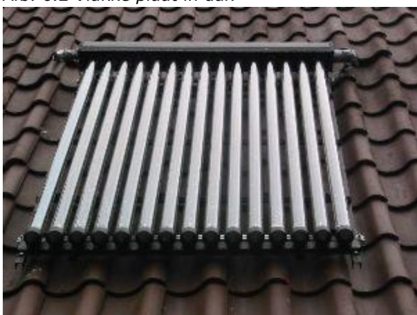
Afb. 6.3 Vacuümbuizen boven dak
