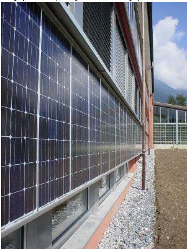
Afb. 2.8 PV-systeem op gevel
