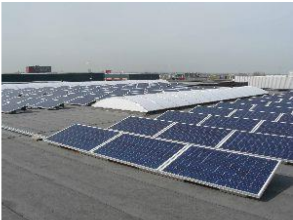
Afb. 2.6 PV-systeem op plat dak
