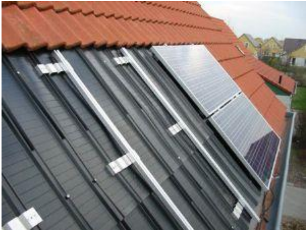
Afb. 2.5 PV-systeem op hellend dak
