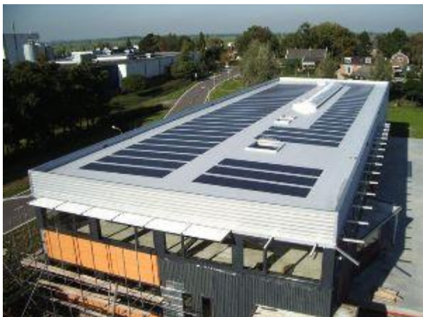
Afb. 2.7 PV-systeem op plat dak
