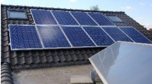
Afb. 2.4 PV-systeem op hellend dak
