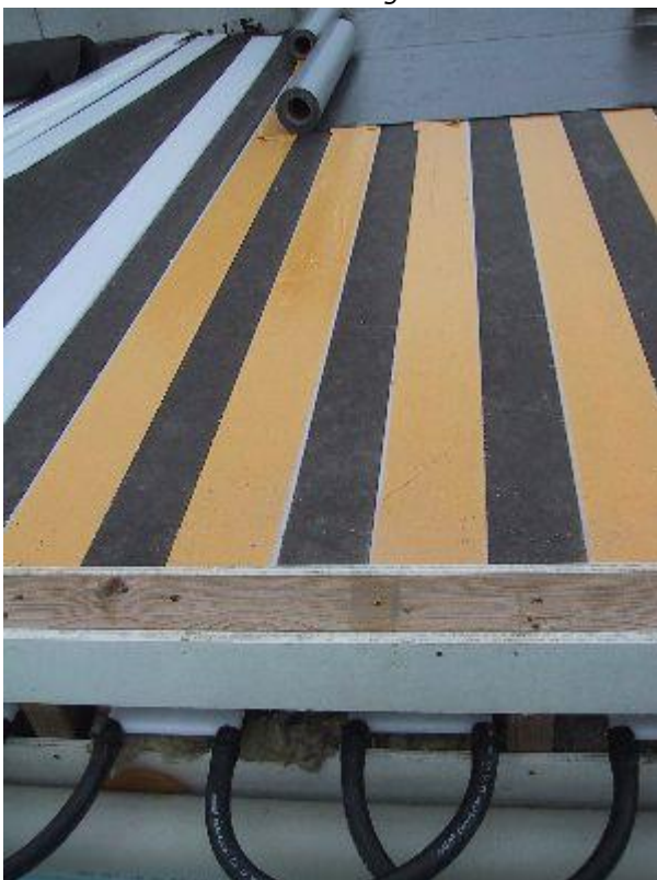
Afb. 6.7 Met dakbedekking geïntegreerd
