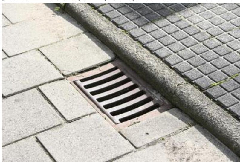
Afb. D.3 Het weglaten van de stankafsluiter in meerdere straatkolken in een straat kan bijdragen aan een lokaal be- en ontluuchtingsprobleem van het straatriool
