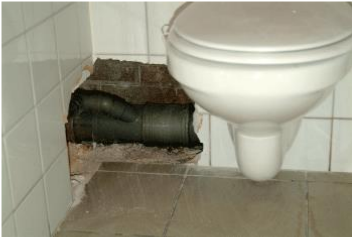
Afb. 4.13a Riolering achter voorzetwand
