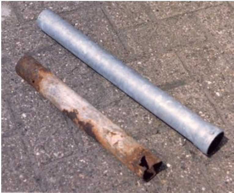
Afb. 7.1 Een verzinkt stalen afvoerleiding is niet bestand tegen onverdund condenswater, afkomstig van HR-ketels
