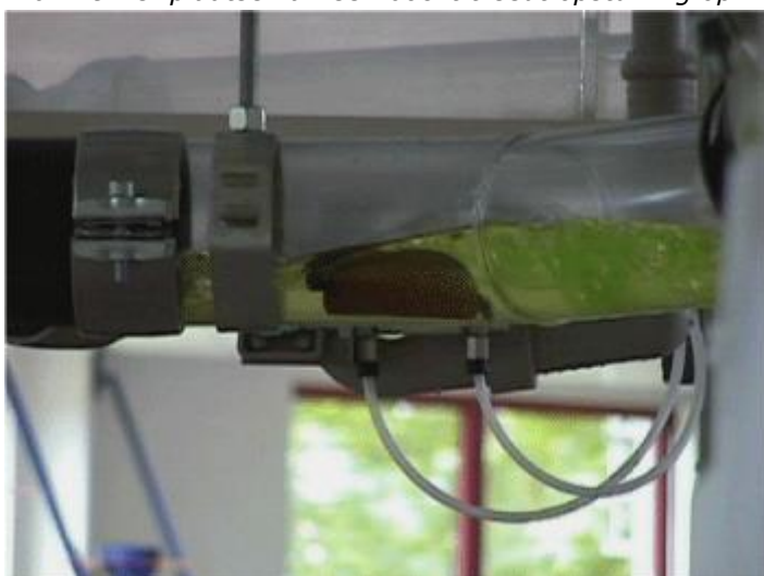
Afb. 4.10 Blijven vaste stoffen in de leiding achter dan veroorzaken die bij een volgende lozing een opstuwing en mogelijk een hydraulische afsluiting:
