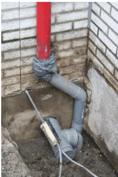
Afb. 17.1 Slecht bereikbare stankafsluiter in hemelwaterafvoer
